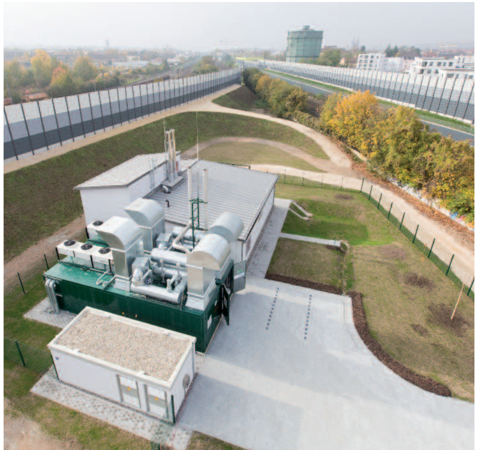
Abseits des Wohn- und Gewerbegebiets wurde das Heizhaus errichtet, in dem zwei Blockheizkraftwerke mit 1,3 Megawatt thermischer und 1,2 Megawatt elektrischer Leistung Wärme und Strom produzieren. Bei großem Wärmebedarf können zwei erdgasbetriebene Spitzenlastkessel mit einer Wärmeleistung von insgesamt 3,8 Megawatt zugeschaltet werden.
