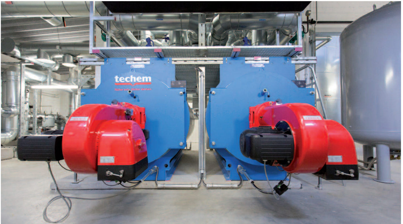
Im Candis-Heizhaus kommt modernste Technik zum Einsatz.
